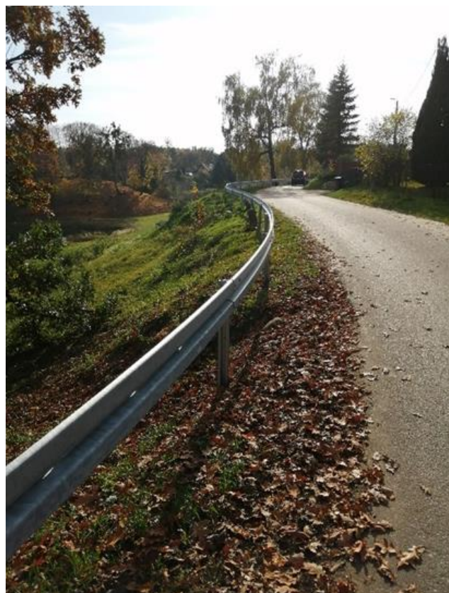
Bariery ochronne Łutynowo (zdjęcie z zasobów własnych Urzędu Miejskiego w Olsztynku)
