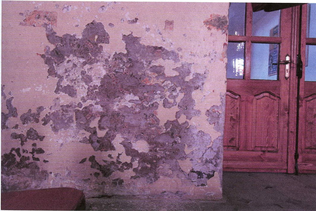
Widok narożnika po stronie północnej. Widoczne złuszczone płyty tynku cementowego.
