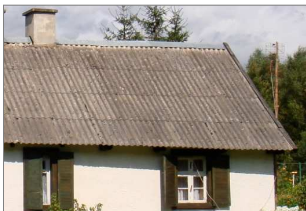
Fot.1 Płyty azbestowo-cementowe faliste
