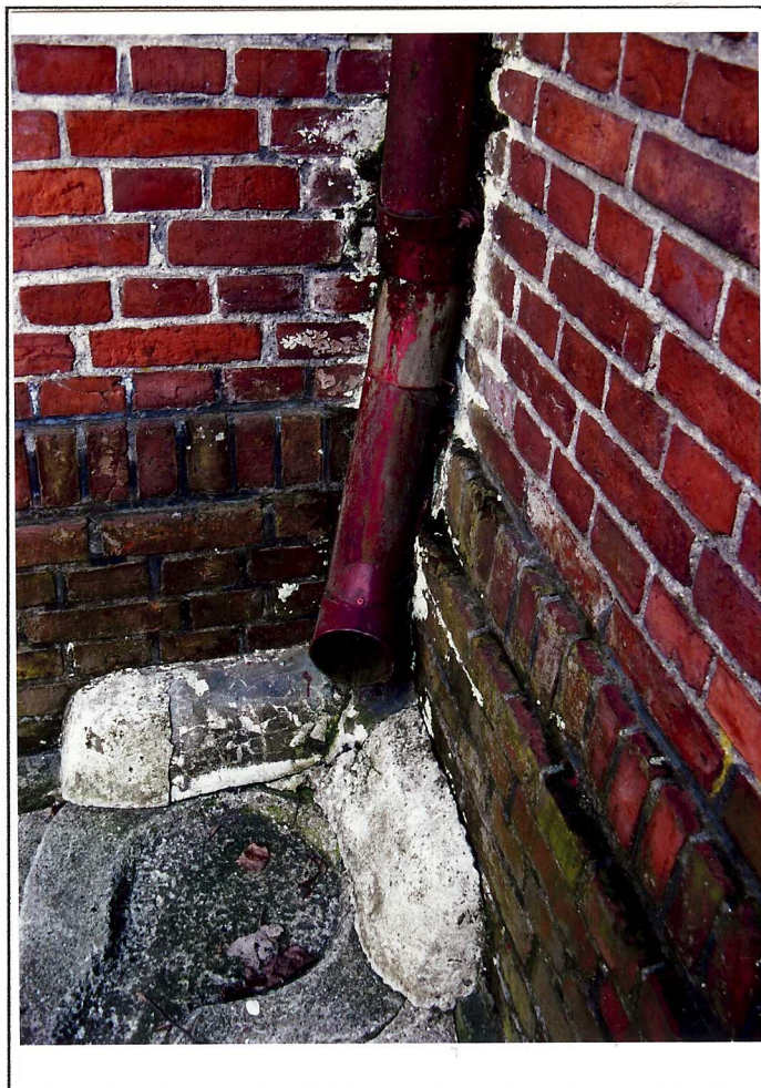
Widok betonowego wałka wykonanego celem polepszenia odpływu wody. Widać iż nie spełnia to swojej funkcji. Beton odspoił się od muru dzięki czemu powstała szczelina przez którą woda swobodnie wpływa.
