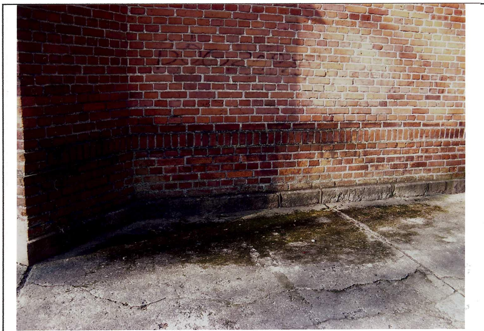
Widok ściany porośniętej glonami. Świadczy to o podwyższonej wilgotności całej strefy cokołowej.
