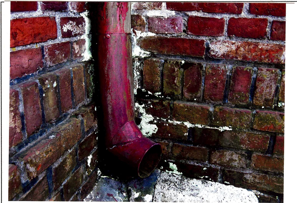
Widok muru z wykwitami gipsowymi i solnymi.
